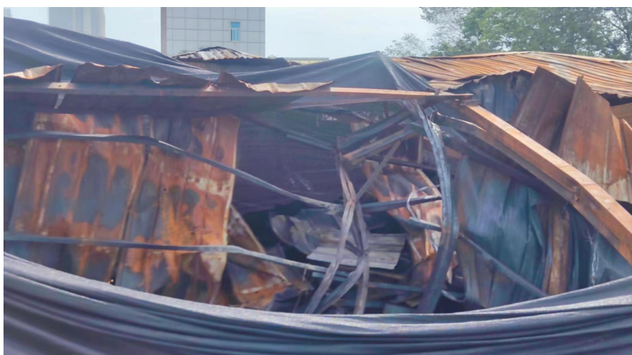
图 4 事故回收点钢结构坍塌图
