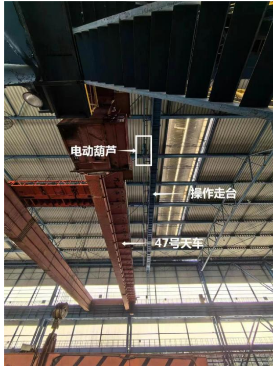
图 2 事故现场仰视图
