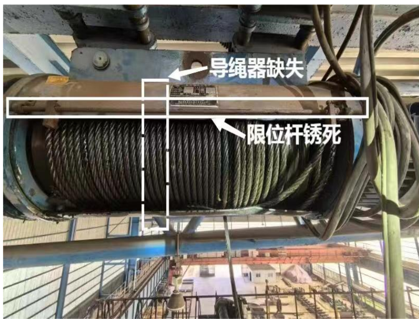
图 5 涉事电动葫芦导绳器缺失、限位杆锈死
