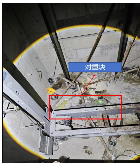
图 12 底坑散落的对重块
